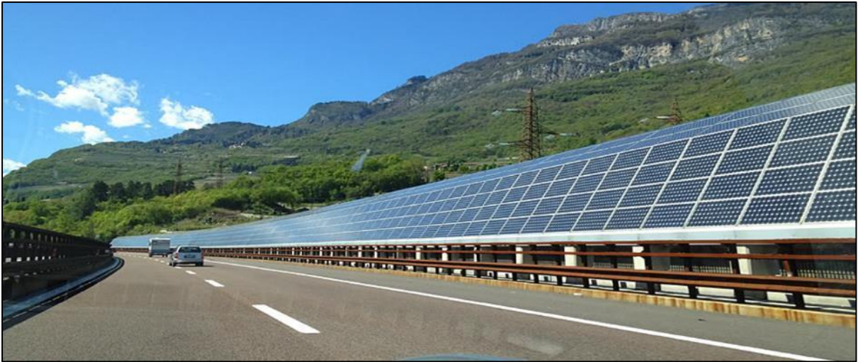
Afbeelding 26: Zonne installatie langs de "Brennerautobahn" in Italië
