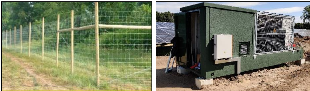
Afbeelding 15: Voorbeeld hekwerk en trafostation (kleur wordt aangepast)
