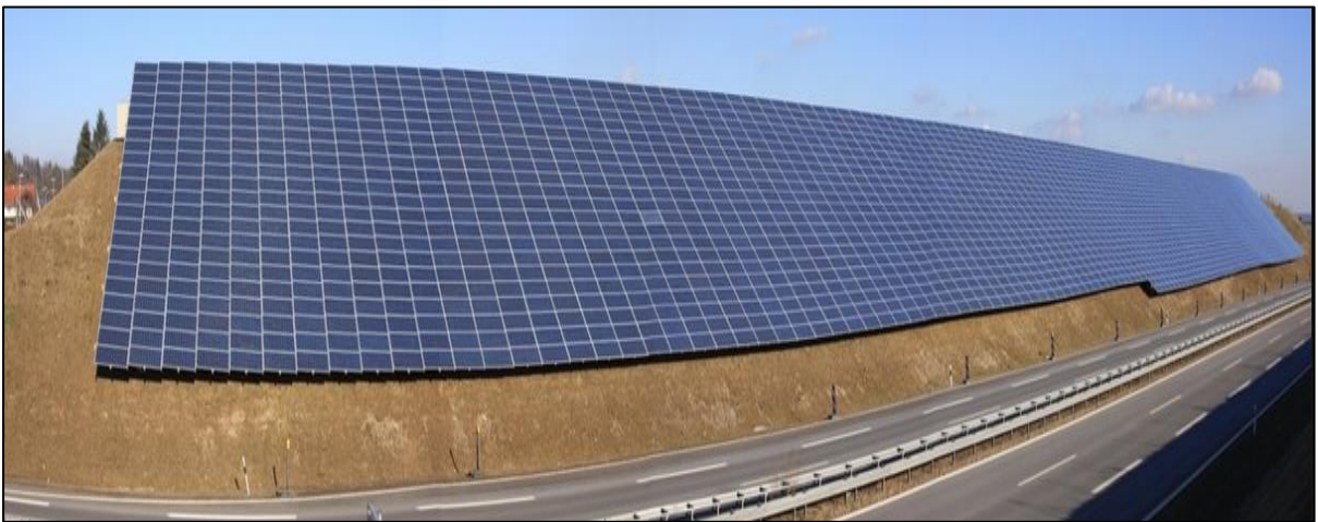
Afbeelding 25: Zonne installatie langs de A94 dicht bij Toting
