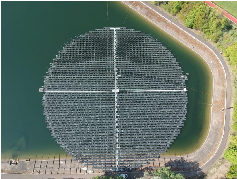
Figuur 3 : Drone-opname van een draaibaar eiland van Floating Solar
