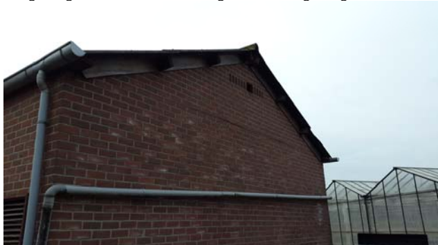
Foto: Asbestverdacht dak met dakgoot
