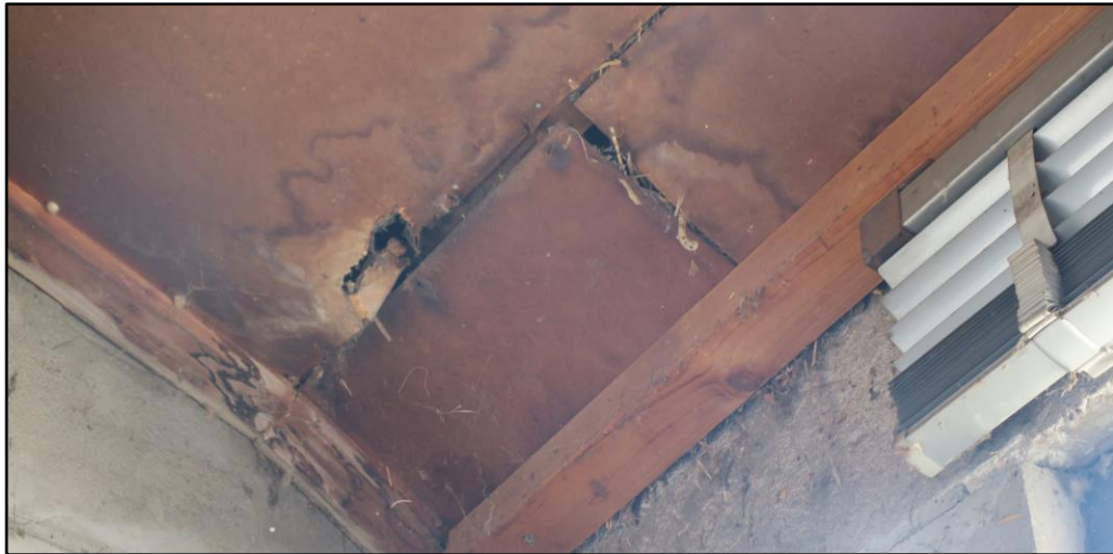
Figuur 7 Aangetroffen nestmateriaal onder het dakbeschot in bedrijfspan 2.
