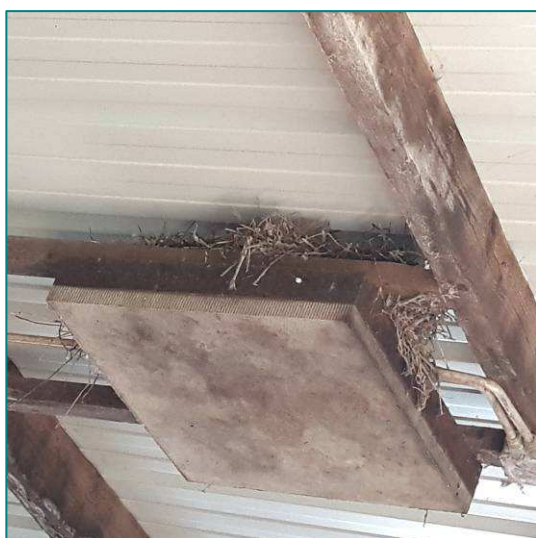
Foto 1: Nestmateriaal van vermoedelijk houtduif in de potstal.
