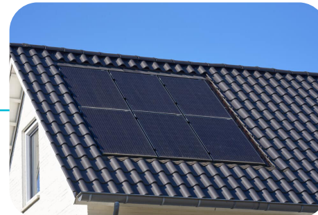
Geïntegreerde zonnepanelen in afstemming met antraciete pannen
