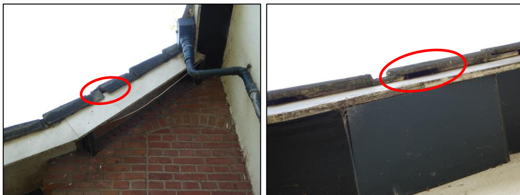
Kieren onder de dakpannen in de bedrijfswoning.
