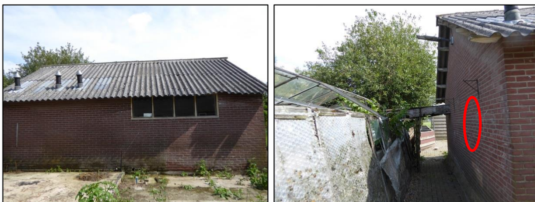
Bedrijfsgebouw 1 met een spleet in de muur aan de noordzijde (rood omkaderd).
