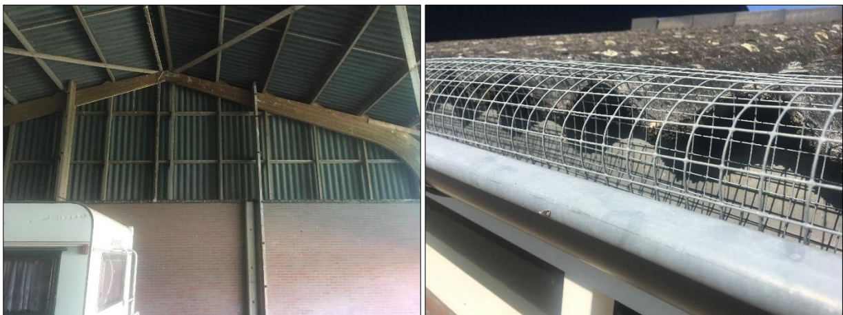
Foto links: potentiële nestlocatie voor vogels in de kapschuur, foto rechts: aangetroffen vogelwering onder de golfplaten.
