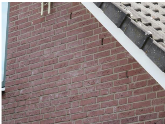
Afbeelding 9: op alle zijgevels van het hoofdgebouw zijn open stootvoegen aanwezig die geschikt zijn voor gebouwbewonende soorten vleermuizen.
