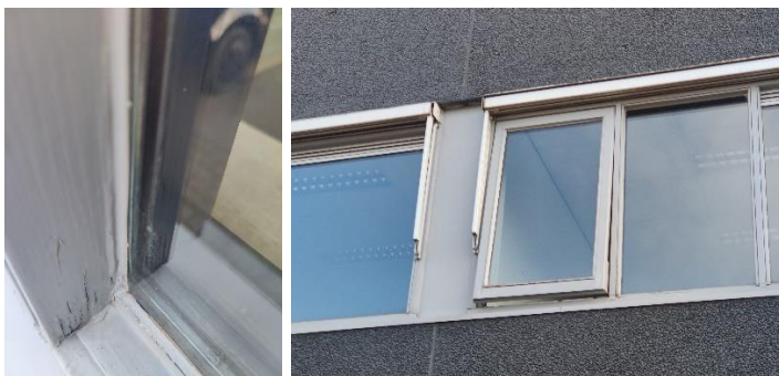
figuur 5 dubbel glas (links) ventilatieroosters (rechts)
