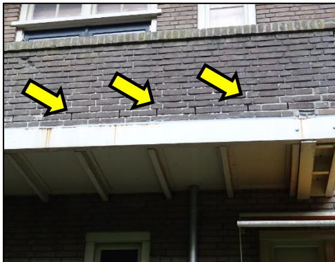
Figuur 15. Balkon met open stootvoegen.
