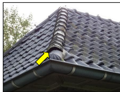
Figuur 12. Losliggende dakpan.
