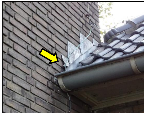
Figuur 16. Loodslabben bij dakrand.
