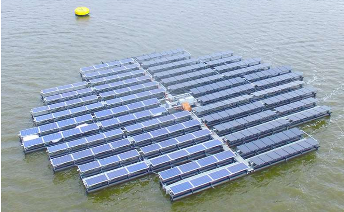
Afbeelding 5.3 Voorbeeld van een drijvende zonne-energie installatie, testen op de Slufter
