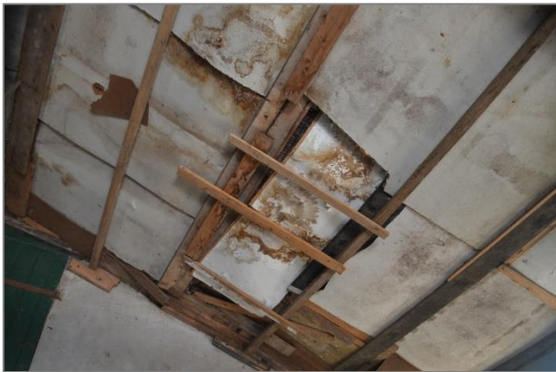
Afbeelding 2.5 | Het zwaar beschadigde dakbeschot van het lagere tussen gebouwtje.
