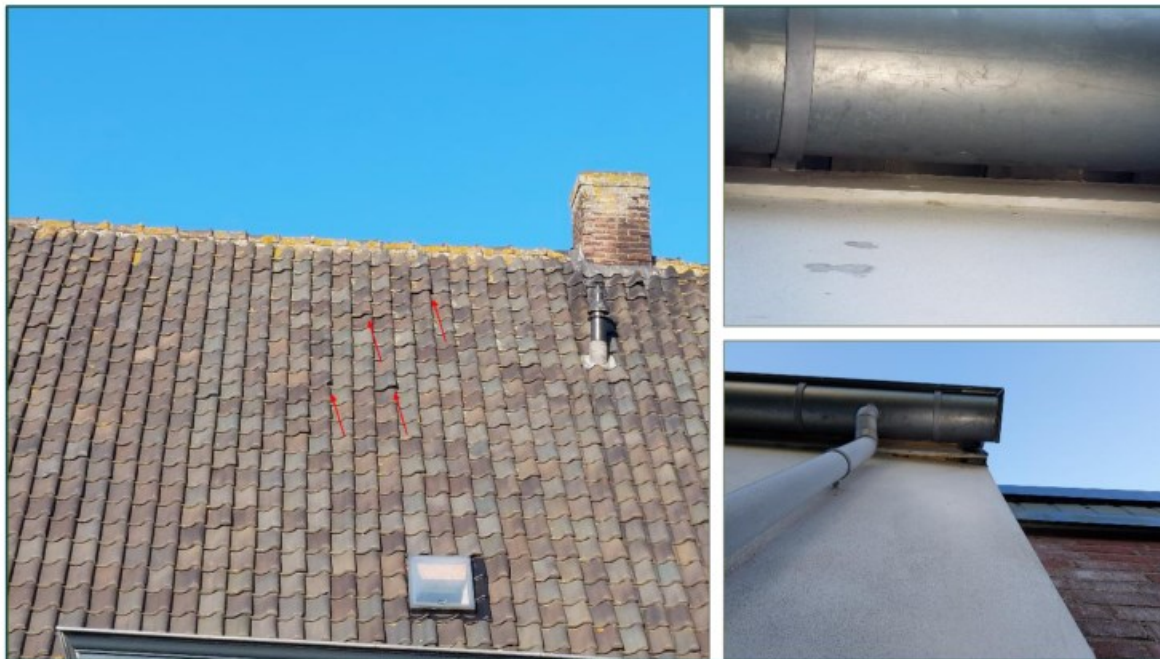
Figuur 3.1 In het winkelpand zijn verschillende openingen aanwezig, waaronder scheefliggende pannen en openingen onder de dakgoot. Dergelijke openingen leiden naar de open spouw- en dakruimte en bieden mogelijk geschikte verblijfplaatsen voor gebouwbewonende vleermuizen.
