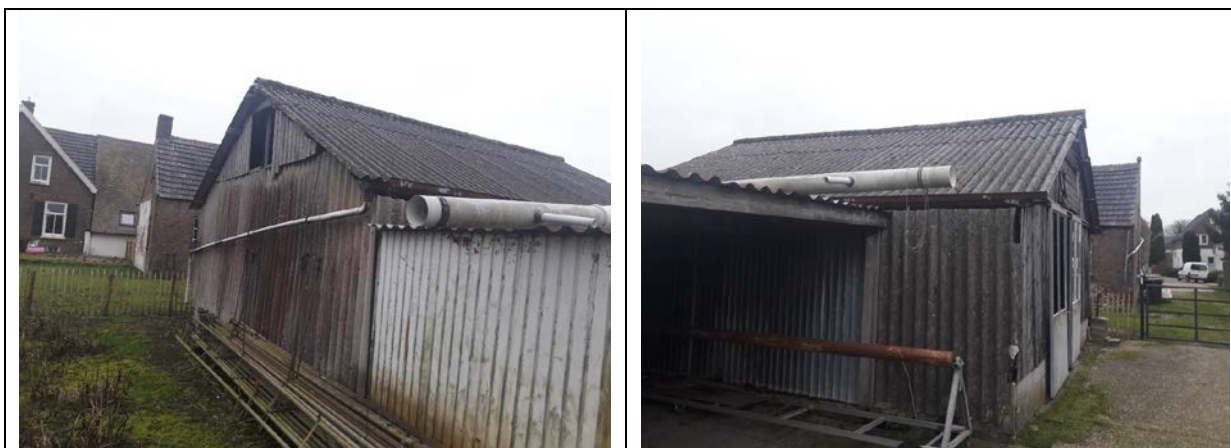
Schuur met asbestverdachte dakbedekking en gevelbekleding
