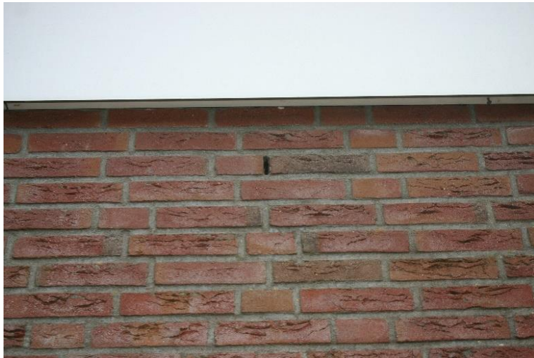
Figuur 4.4.3. Open stootvoeg in de buitengevel het kantoor.
