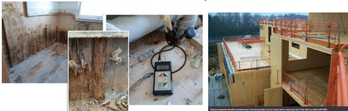
Figuur 1: Links: Schadegevallen door water en vocht. Rechts: Project in uitvoering zonder maatregelen (slecht voorbeeld).
