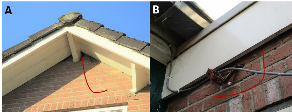
Figuur 2 (A): aanwezige opening in de nok van de oostgevel en (B): opening bij de aanbouw onder de boeiborden.
