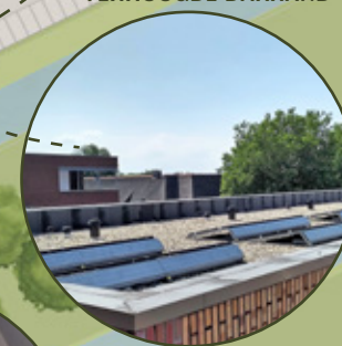
ZONNEPANELEN ACHTER VERHOOGDE DAKRAND
