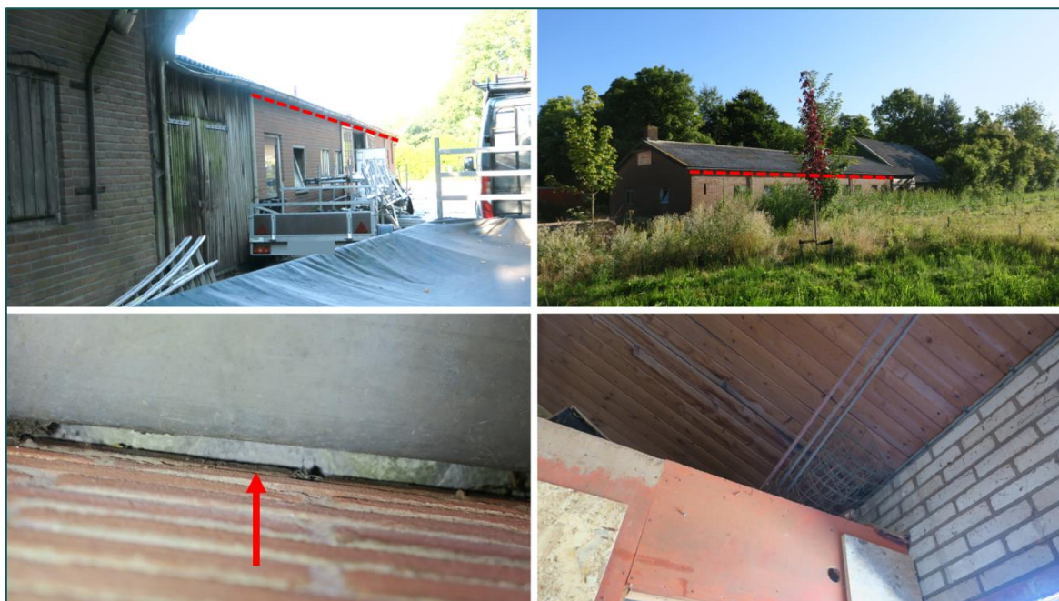
Figuur 3.1 Zowel de noordelijke als de zuidelijke gevel van een gedeelte van de schuur (zie gestippelde lijn in bovenste foto's voor potentiële plekken) beschikken over een kier achter de dakgoot (foto links onder) welke leidt tot de open dakruimte. De schuur is namelijk gedeeltelijk voorzien van houten dakbeschot (foto rechts onder).
