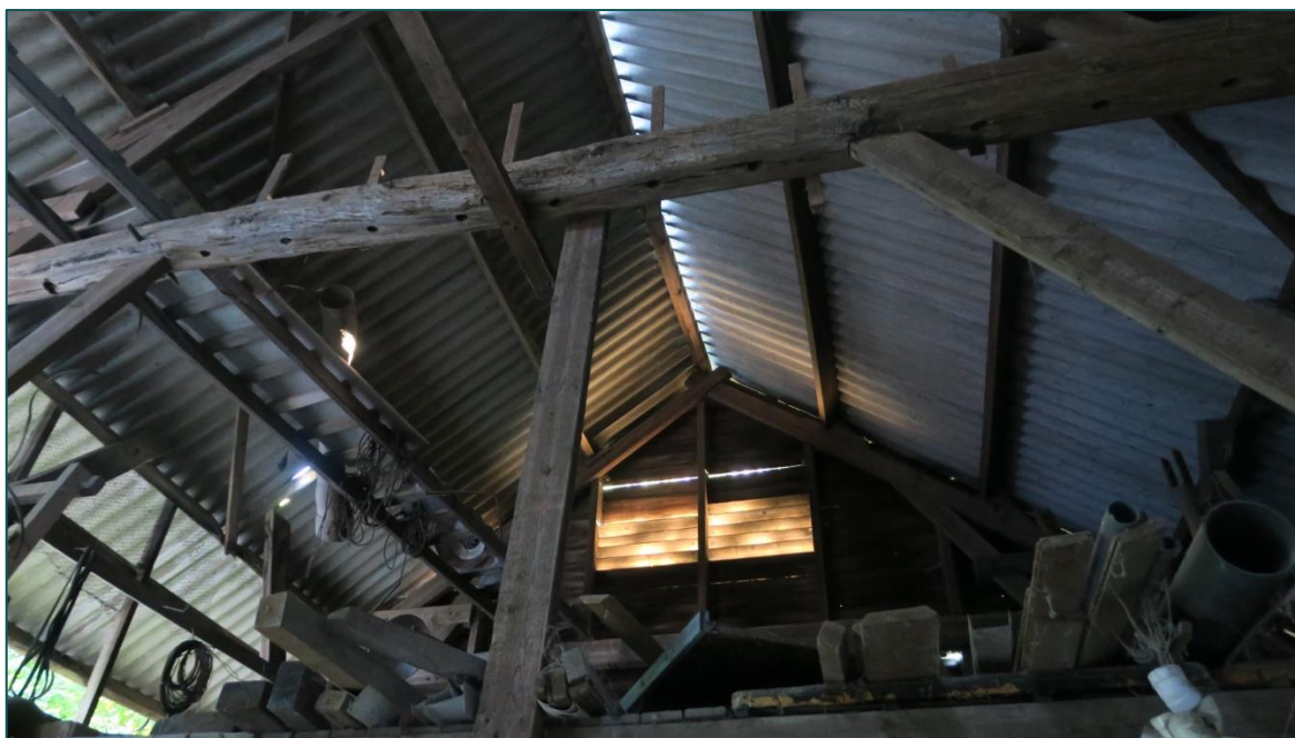
Figuur 8 Het oostelijke deel van de te slopen schuur (1) beschikt niet over dakbeschoot.
