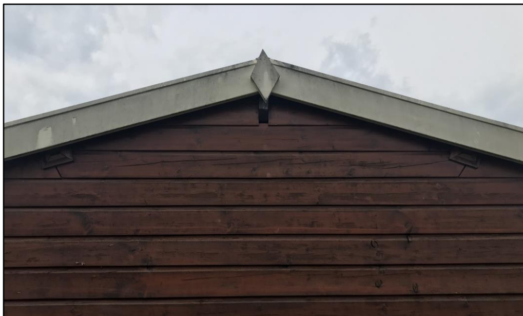
Figuur 4 De blokhut met zichtbaar ruimte onder de nok achter de windveer. Deze ruimte bleek bij nadere inspectie geen achterliggende ruimte te bevatten.
