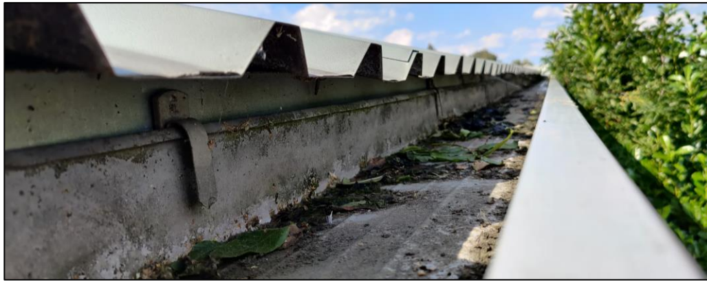
Figuur 5 Visuele representatie van dakgoot van loods B.
