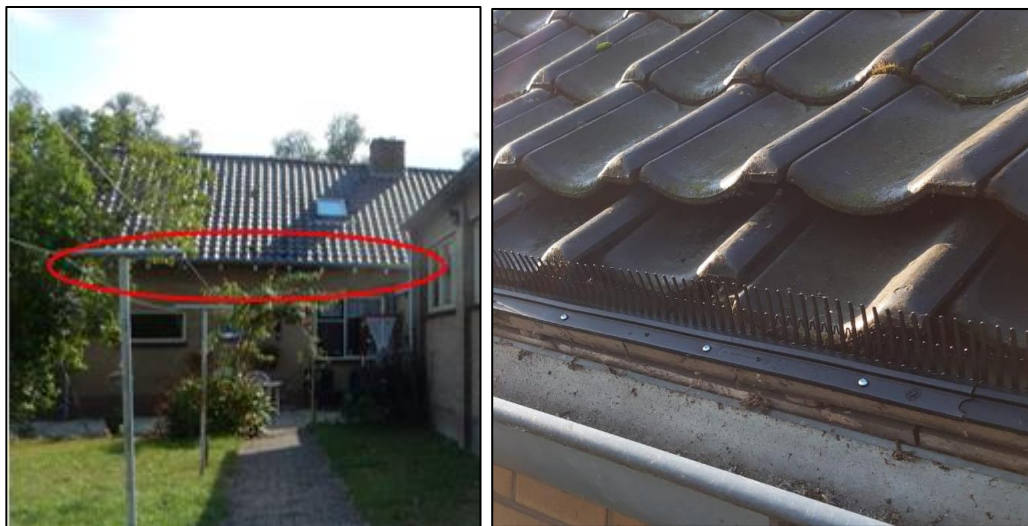
Figuur 6 Visuele representatie van dakgoot met vogelschroot van de woning ten zuiden van de planlocatie.
