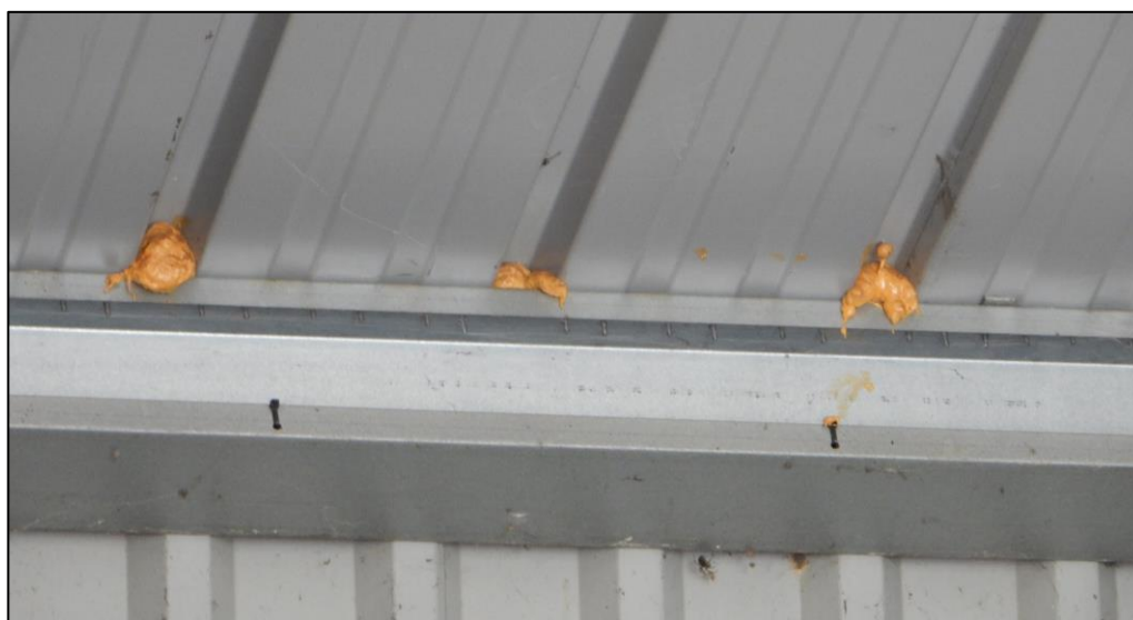
Figuur 4 Visuele representatie van de opgevulde gaten tussen het dak en de muur van loods A.
