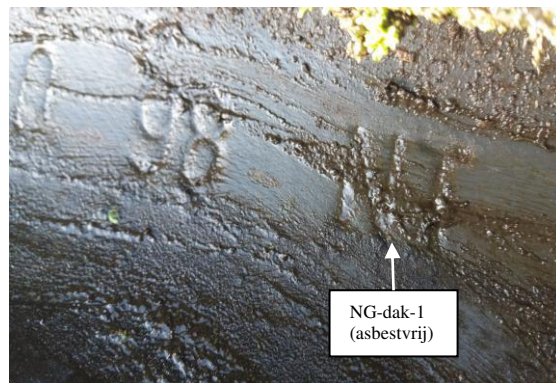
Foto 14: NT-code in asbestvrije golfplaat als dakbedekking van schuur 3. (98 NT)
