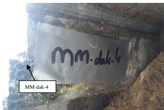
Foto 9: Asbesthoudende golfplaat als dakbedekking van schuur 2.
