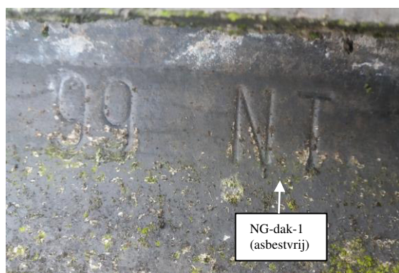
Foto 15: NT-code in asbestvrije golfplaat als dakbedekking van schuur 3. (99 NT)
