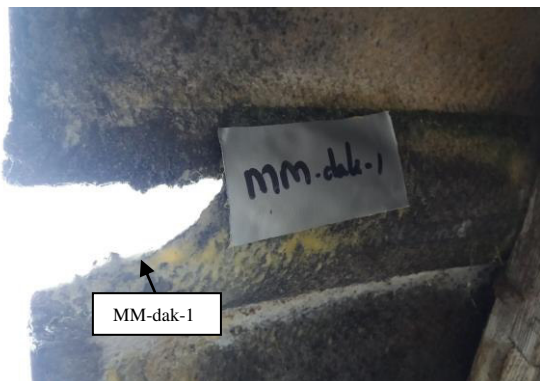
Foto 1: Asbesthoudende golfplaat als dakbedekking van schuur 1.
