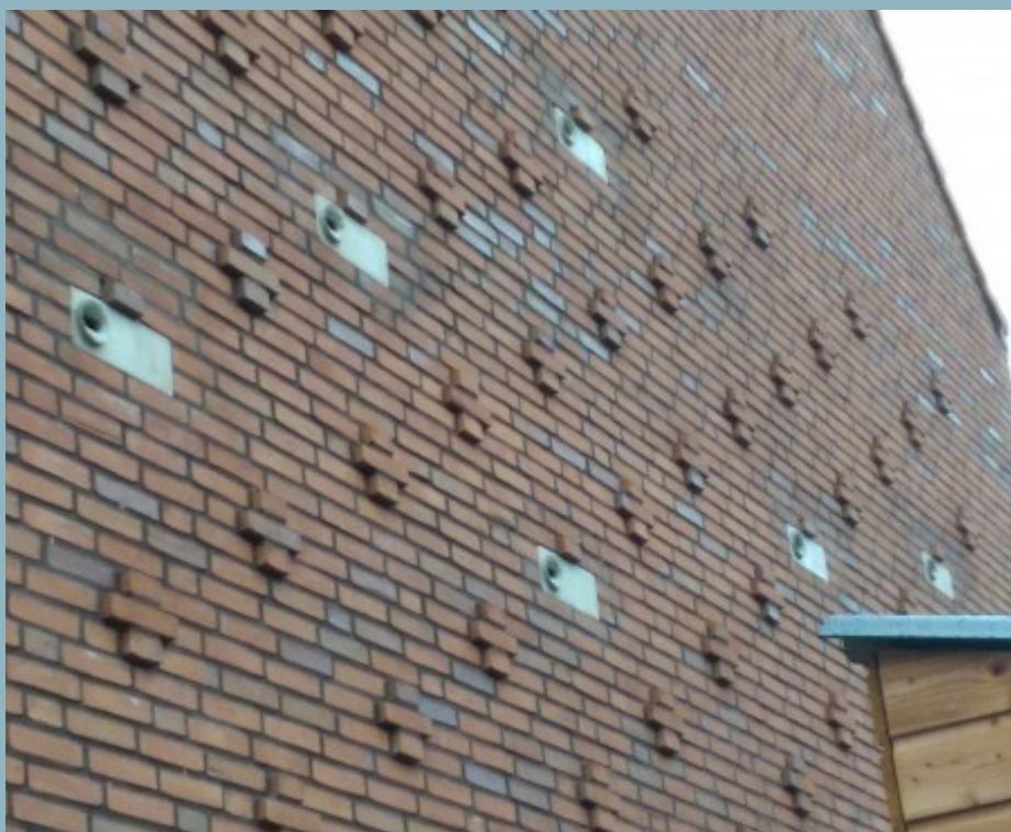
Gierzwaluwkasten in de gevel
