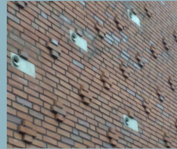
gierzwaluwkasten in de gevel
