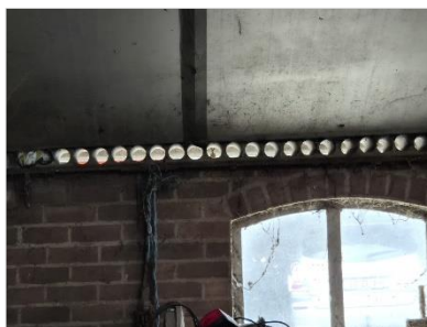
Figuur 4.10 Openingen onder dak van schuur IJsseldijk 90 (gebouwcluster 4).
