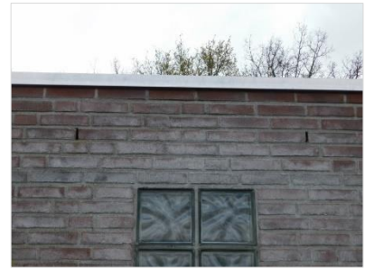
Figuur 4.30 Open stootvoegen in het clubhuis van Voetbalclub Avw'66 (gebouwcluster 9).
