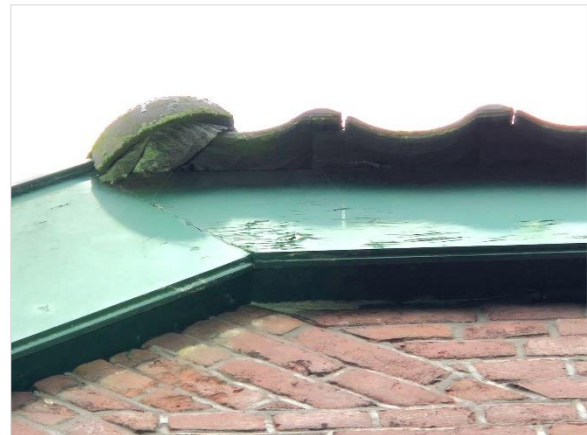
Figuur 4.12 Openingen onder kantpannen in de woning aan IJsseldijk 88 (gebouwcluster 6).
