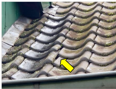
Figuur 4.7 Openingen onder verschoven dakpannen in woning IJsseldijk 88 (gebouwcluster 6).
