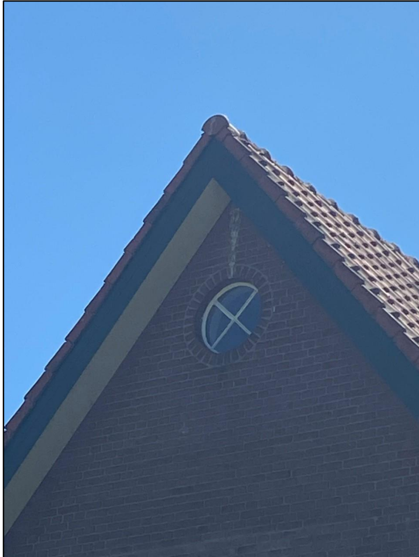
Sporen van gierzwaluw in daknok, duidend op een mogelijke nestplaats
