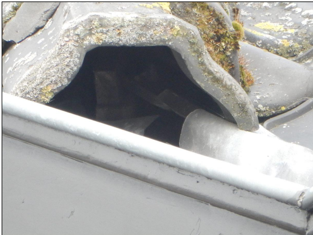
Figuur 5 De nokvorsten van de bebouwing zijn niet afgedicht. Dit geeft huismussen de toegang om de ruimte onder de dakpannen te bereiken.
