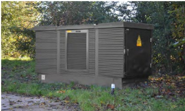
Figuur 7. Kleurgebruik transformatoren- en bijgebouwen
