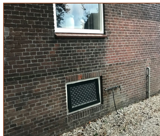
Afb. 2.9: Door het openstaande raampje kunnen kleine zoogdieren zoals huismuis en bruine rat de kelder bereiken gebruiken als vaste rust- en verblijfplaats. Echter is deze normaal gesproken gesloten en geldt voor deze soorten een vrijstelling.
