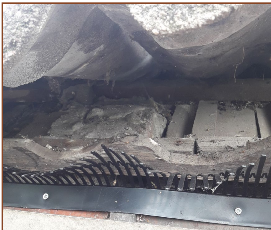
Afb. 2.2: De woning bevat een pannendak dat in eerste instantie geschikt is voor huismussen. Echter is door het aanbrengen van vogelvides het dak ontoegankelijk voor huismussen en dus ongeschikt.
