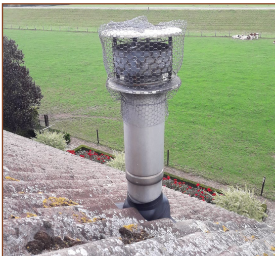
Afb. 2.4: De schoorstenen van de woning zijn dichtgezet met gaas waardoor broedvogels deze niet kunnen gebruiken als broedplaats.
