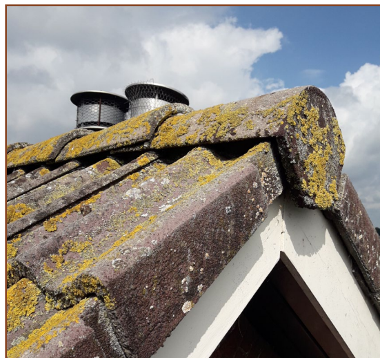
Afb. 2.5: De nokpannen zijn aangebracht met cement waardoor geschiktte openingen voor vleermuizen om de spouw binnen te treden ontbreken.
