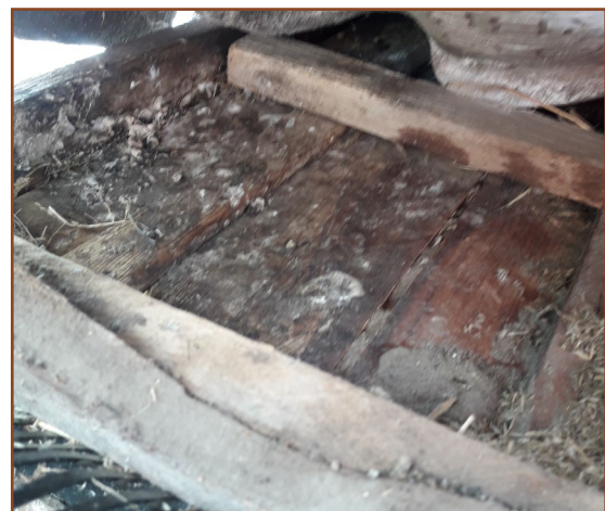
Afb. 2.3: Onder de pannen zijn wel oude sporen aanwezig van huismussen zoals uitwerpselen. Hedendaags zijn geen mogelijkheden voor huismussen aanwezig.
