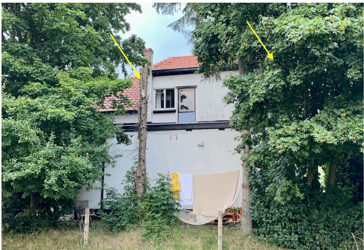
Foto 4 | Westzijde van het dak met indicatieve weergaven van de aangetroffen nesten. De pijlen markeren de plaats waar huismussen onder de dakpannen gaan, de nestplaatsen bevinden zich in de buurt van deze ingang onder de dakpannen. Door de aanwezige bomen is het dakvlak op deze foto beperkt zichtbaar.
