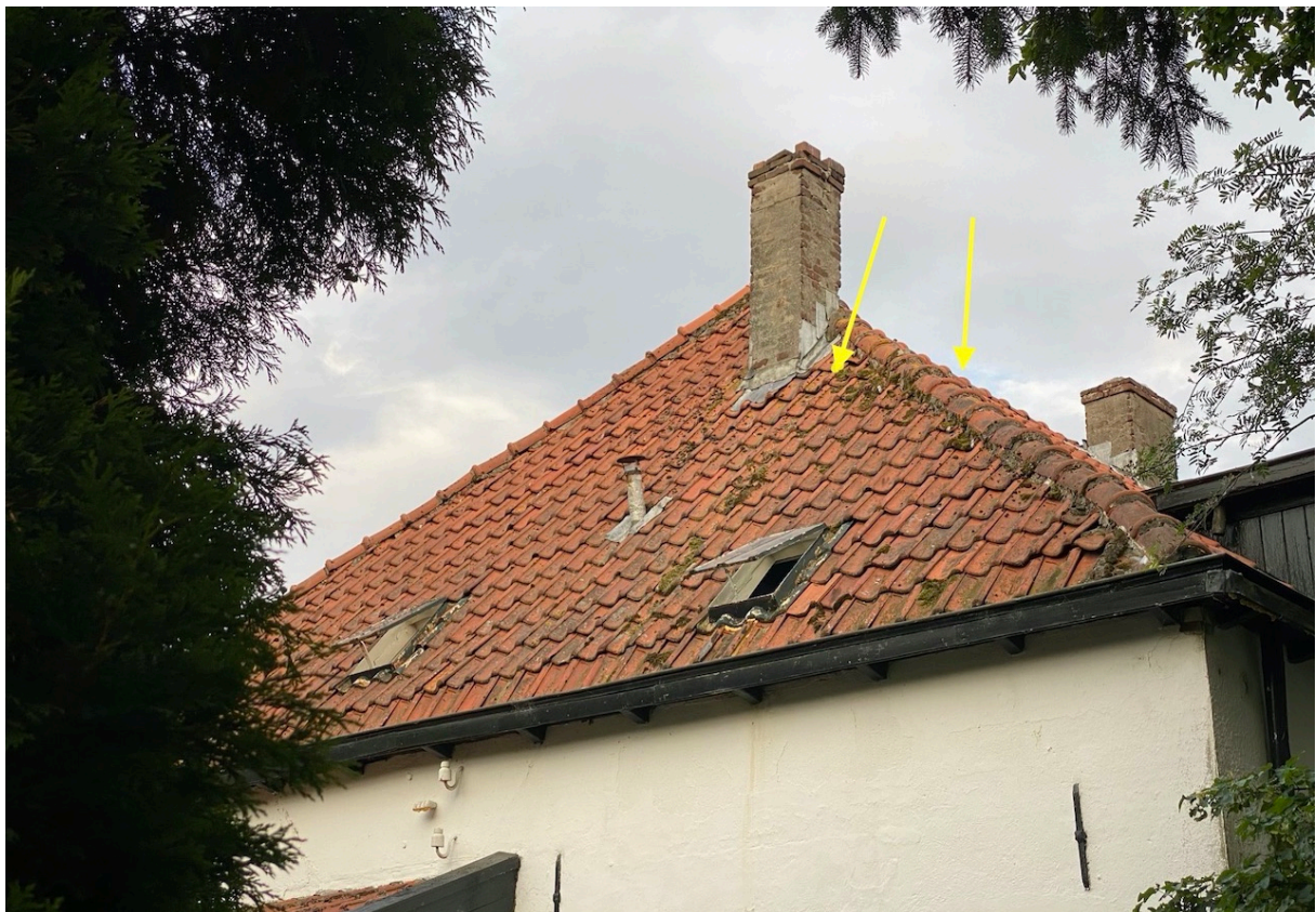
Foto 3 | Noord en westzijde van het dak met indicatieve weergaven van de aangetroffen nesten. De pijlen markeren de plaats waar huismussen onder de dakpannen gaan, de nestplaatsen bevinden zich in de buurt van deze ingang onder de dakpannen. Links naast de schoorsteen (noordzijde dak) is een spreuwenest aangetroffen.
