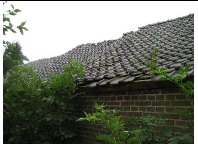
Foto 22: Ingezakt dak (F)
