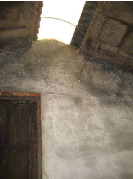
Foto 9: Opening in gevel met sporen Kerkuil (B)
