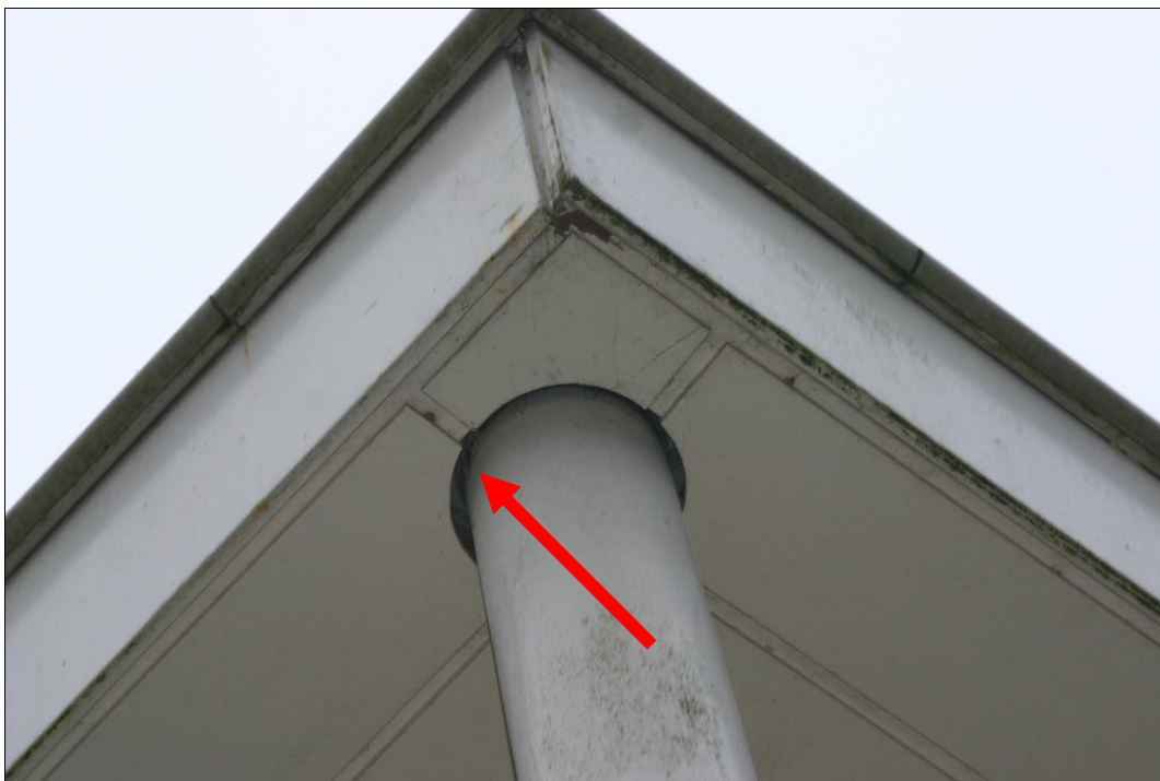
Figuur 4.2.1. De openingen in gebouw A (aangeduid met een rode pijl) zijn ongeschikt voor vleermuizen.
