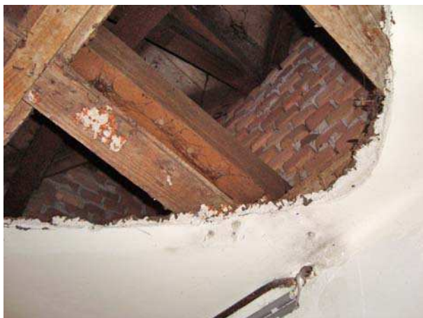
Figuur 19. Vliering van het trappenhuis met kapot plafond.
