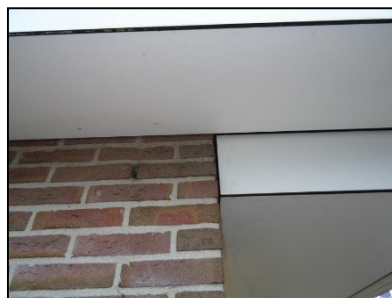
Figuur 20. Open stootvoeg en spleet in de kledingwinkel waar vleermuis doorheen zou kunnen.
