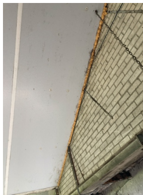
Voorbeeld van kier in de aansluiting van het dakvlak op de draagmuren. Deze opening is afgesloten met PUR-schuim.
