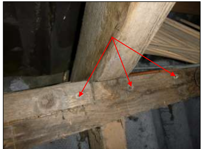
Foto 22: Schuur 1, verdieping: Restanten vlakke plaat (Bron 17) (Asbesthoudend)
