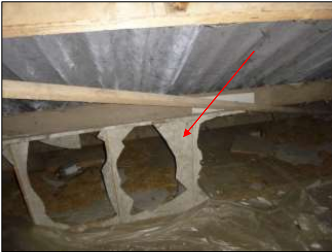
Foto 19: Schuur 1, verdieping: Restanten vlakke plaat (Bron 17) (Asbesthoudend)
