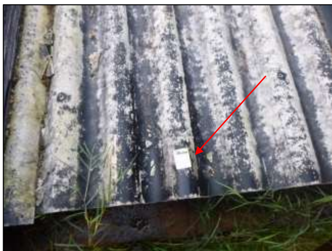
Foto 9: In een container: Golfplaten & restanten plaatmateriaal (Bron 1) (Asbesthoudend)
