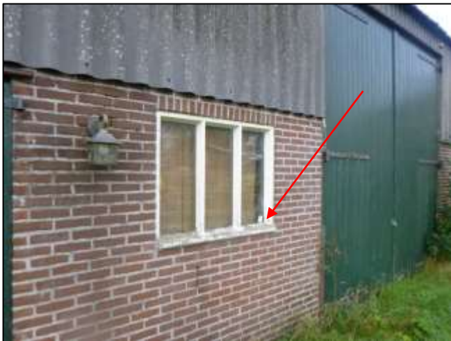
Foto 55: Schuur 1 & 2, betonnen kozijnen (enkel glas): Beglazingskit (Bron 4) (Asbesthoudend)
