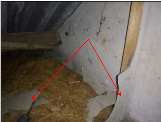
Foto 27: Schuur 1, verdieping: Restanten vlakke plaat (Bron 17) (Asbesthoudend) & Schuur 1 & 2, verdieping: Restanten vlakke plaat (Bron 18) (Asbesthoudend)
