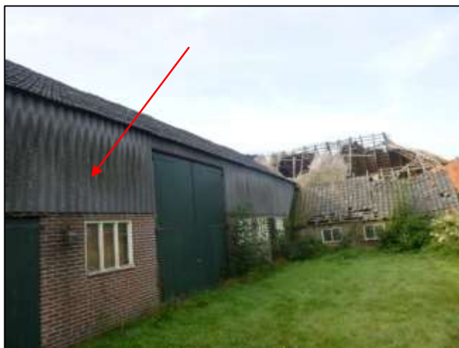
Foto 49: Schuur 1, buitengevel: Golfplaten (Bron 14) (Asbesthoudend)
