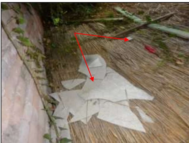
Foto 23: Schuur 1 & 2, verdieping: Restanten vlakke plaat (Bron 18) (Asbesthoudend)
