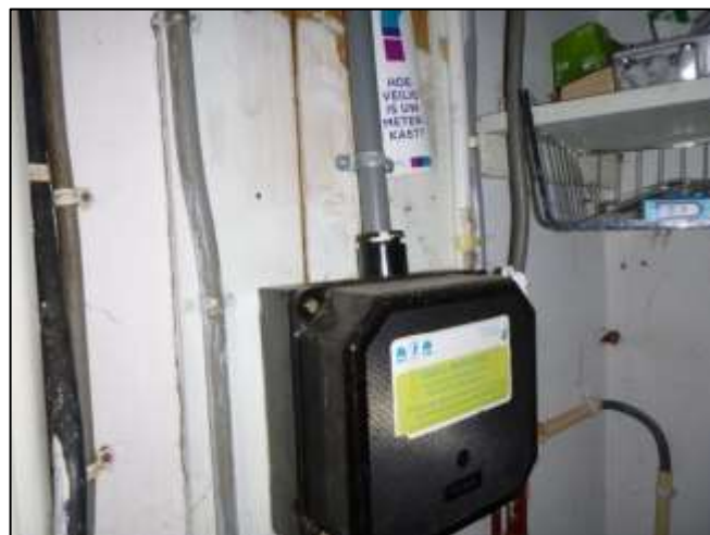
Foto 92: Meterkast: Hoofdzekeringkast (Niet asbestverdacht)
