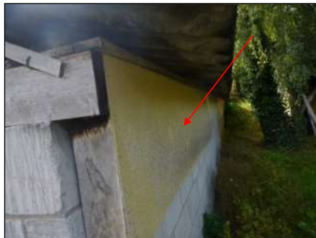
Foto 64: Schuur 3, zijgevels: Vlakke plaat (Bron 5) (Asbesthoudend)
