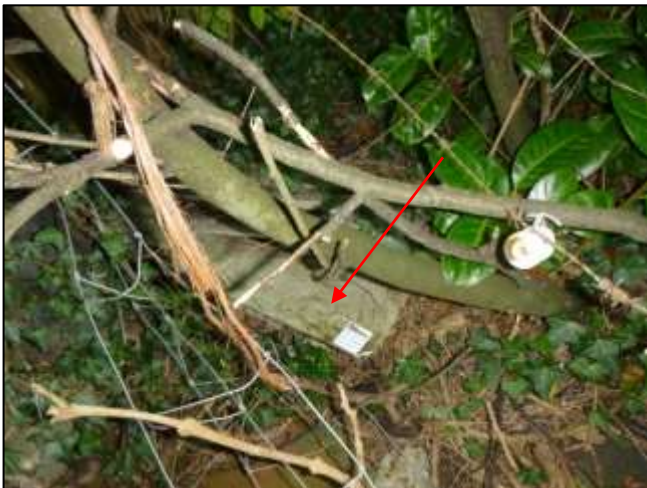
Foto 75: Maaiveld tussen schuur 4 en de weg: Vlakke plaat (Bron 8) (Asbesthoudend)
