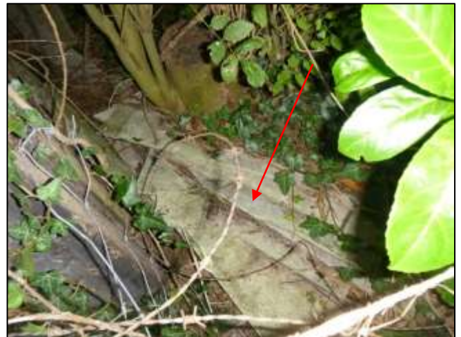
Foto 76: Maaiveld tussen schuur 4 en de weg: Vlakke plaat (Bron 8) (Asbesthoudend)
