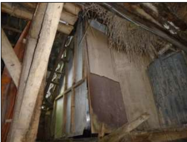
Foto 41: Schuur 2: Ontluchtingskoker (Niet asbestverdacht)
