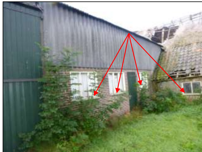
Foto 56: Schuur 1 & 2, betonnen kozijnen (enkel glas): Beglazingskit (Bron 4) (Asbesthoudend)
