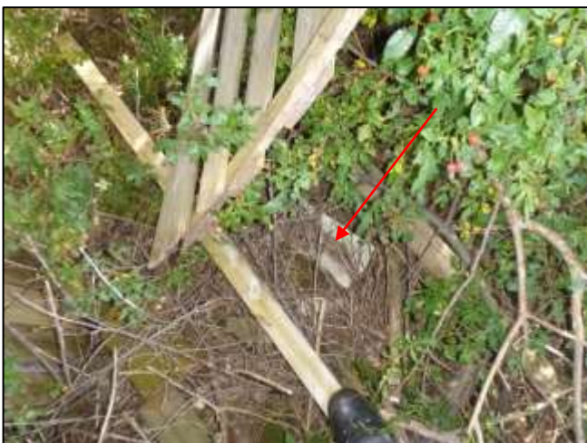
Foto 77: Maaiveld achter schuur 4: Restanten golfplaat (Bron 22) (Asbesthoudend)
