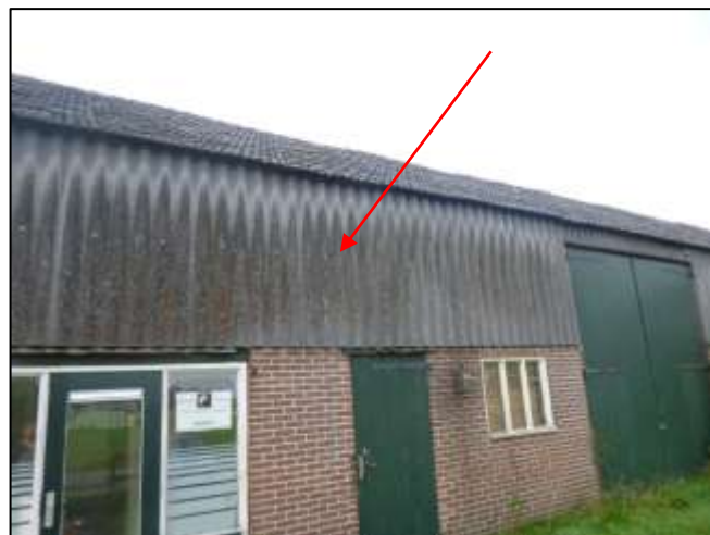
Foto 48: Schuur 1, buitengevel: Golfplaten (Bron 14) (Asbesthoudend)
