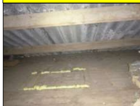
Schuur 1, verdieping: Restanten golfplaat (Bron 15) (Asbesthoudend)
