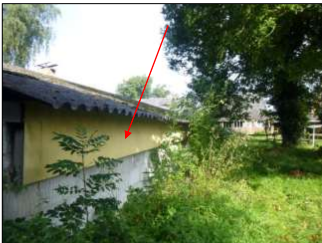
Foto 63: Schuur 3, zijgevels: Vlakke plaat (Bron 5) (Asbesthoudend)
