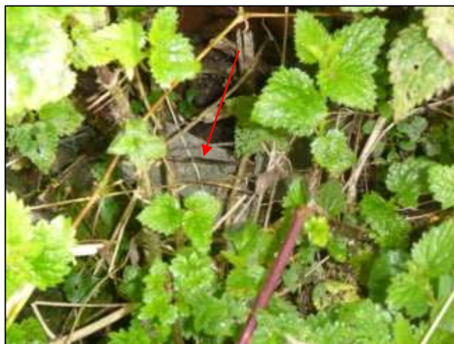
Foto 14: Maaiveld naast schuur 1: Restanten golfplaat (Bron 13) (Asbesthoudend)
