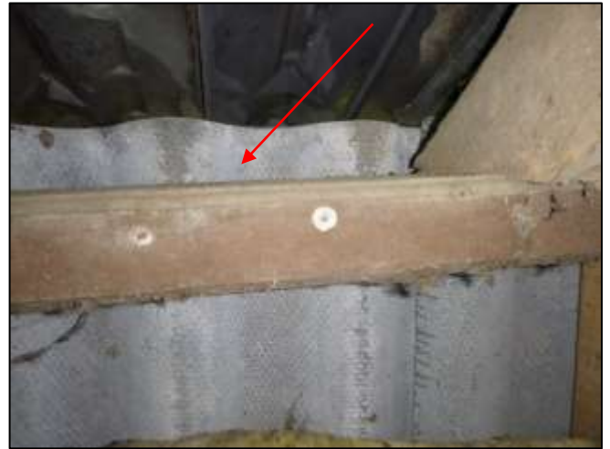
Foto 20: Schuur 1: buitengevel: Restanten golfplaat (Bron 14) (Asbesthoudend)
