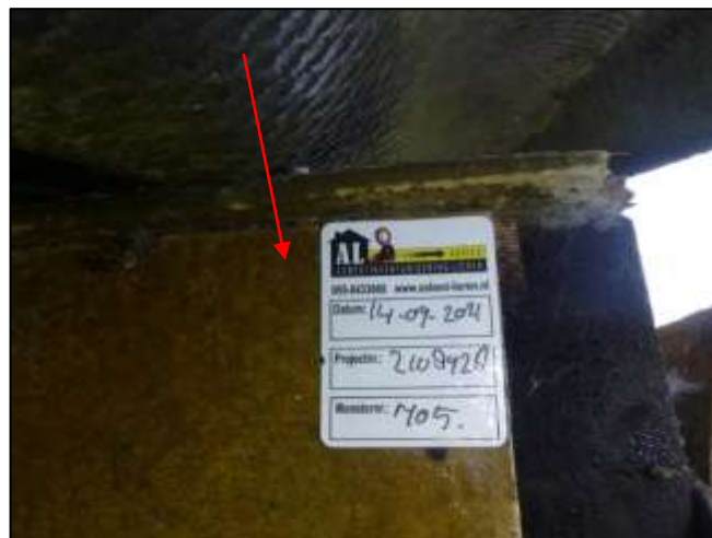
Foto 60: Schuur 3, zijgevels: Vlakke plaat (Bron 5) (Asbesthoudend)
