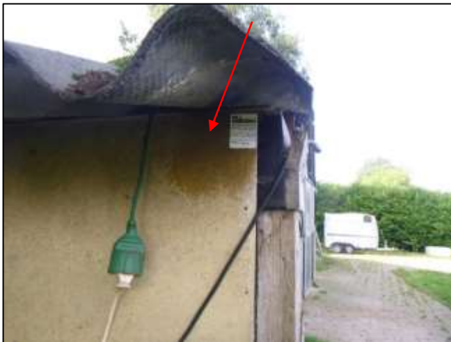
Foto 61: Schuur 3, zijgevels: Vlakke plaat (Bron 5) (Asbesthoudend)
