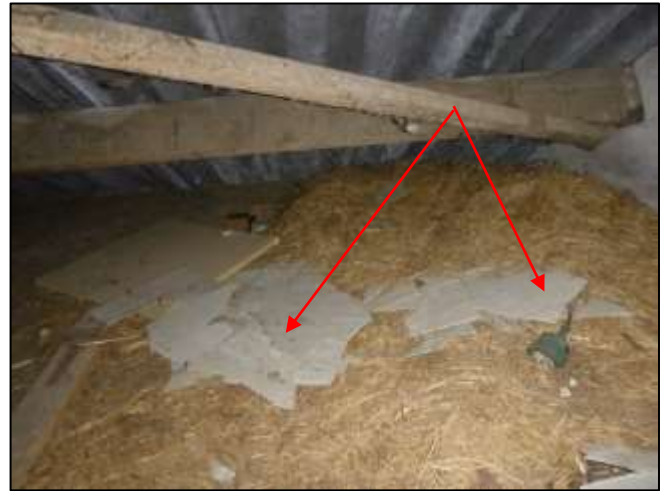
Foto 26: Schuur 1 & 2, verdieping: Restanten vlakke plaat (Bron 18) (Asbesthoudend)
