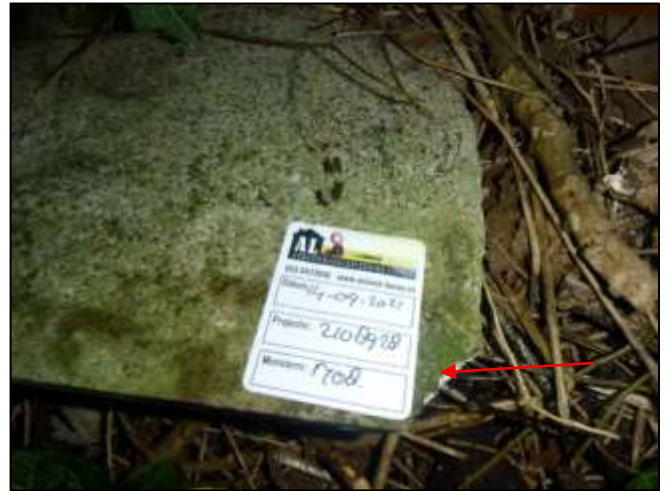
Foto 74: Maaiveld tussen schuur 4 en de weg: Vlakke plaat (Bron 8) (Asbesthoudend)
