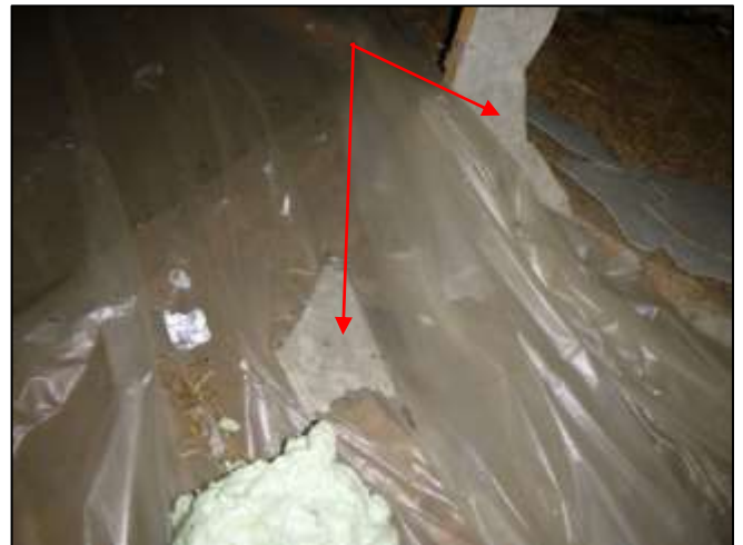
Foto 28: Schuur 1 & 2, verdieping: Restanten vlakke plaat (Bron 18) (Asbesthoudend)
