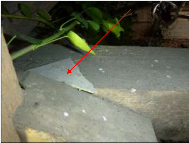
Foto 25: Schuur 1 & 2, verdieping: Restanten vlakke plaat (Bron 18) (Asbesthoudend)
