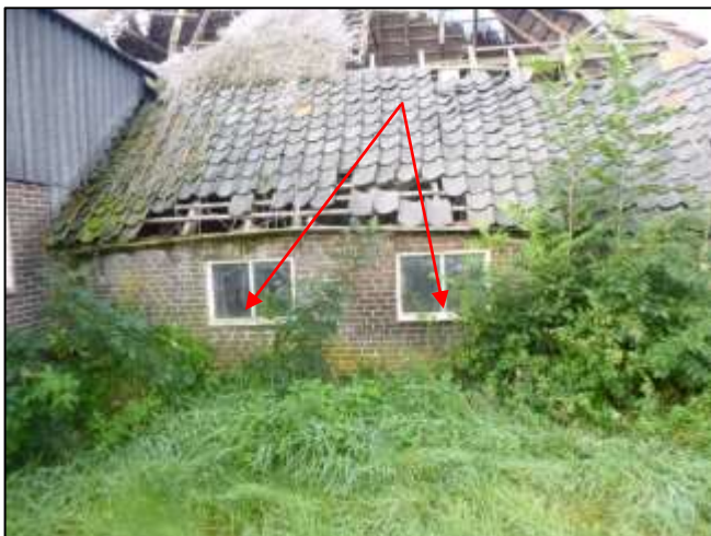
Foto 57: Schuur 1 & 2, betonnen kozijnen (enkel glas): Beglazingskit (Bron 4) (Asbesthoudend)
