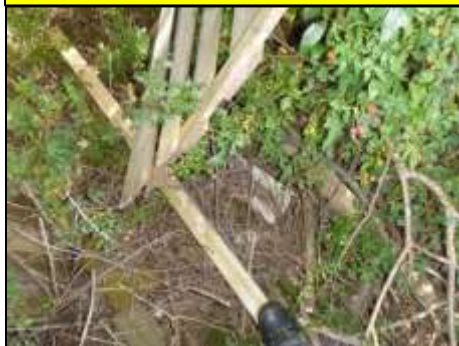
Maaiveld achter schuur 4: Restanten dakbeschoot (Bron 22) (Asbesthoudend)
