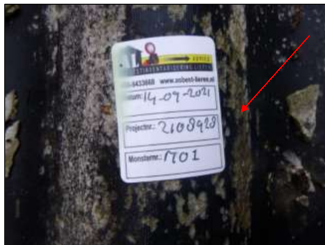
Foto 8: In een container: Golfplaten & restanten plaatmateriaal (Bron 1) (Asbesthoudend)
