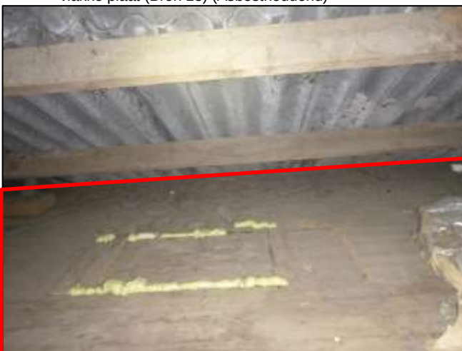
Foto 29: Schuur 1, verdieping: Restanten golfplaat (Bron 15) (Asbesthoudend)
