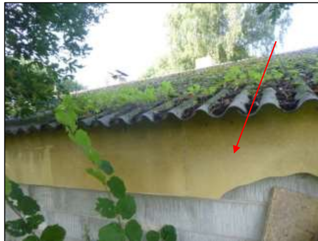
Foto 62: Schuur 3, zijgevels: Vlakke plaat (Bron 5) (Asbesthoudend)
