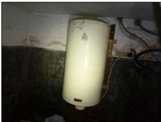
Foto 91: Kelder: Boiler (Niet asbestverdacht)
