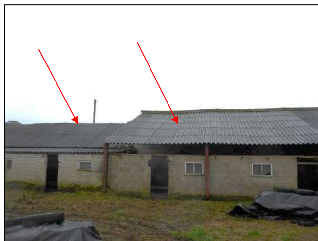
Foto 42: Schoor 2: Golfplaten dak (M08AA)
