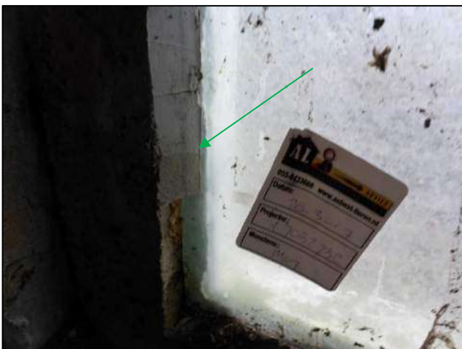
Foto 35: Schuur 2: Stopverf (M06V & M07V)
