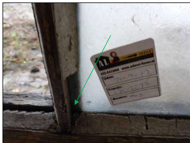
Foto 16: Schuur 1: Stopverf (M02V & M03V)
