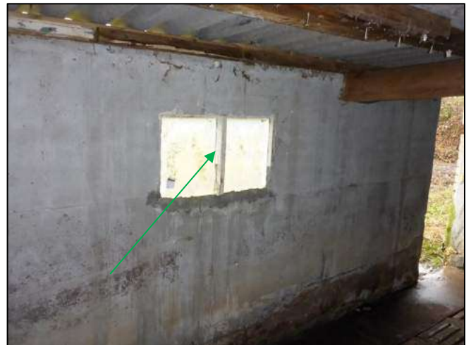
Foto 34: Schuur 2: Stopverf (M06V & M07V)
