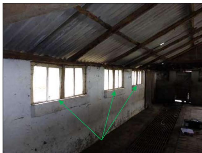
Foto 18: Schuur 1: Stopverf (M02V & M03V)
