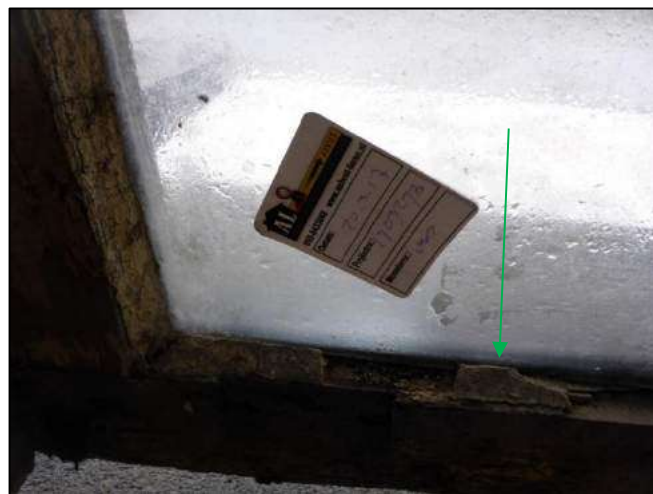
Foto 14: Schuur 1: Stopverf (M02V & M03V)
