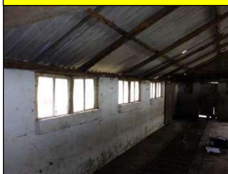
Buitengevel schuur 1: Stopverf (M02V + M03V)
