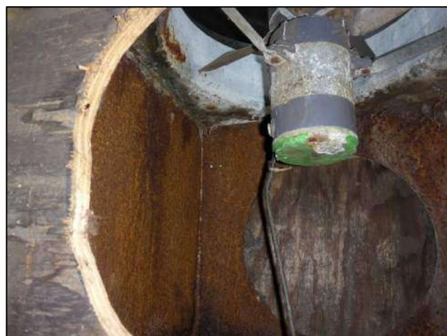
Foto 30: Schuur 2: Ventilatie koker
