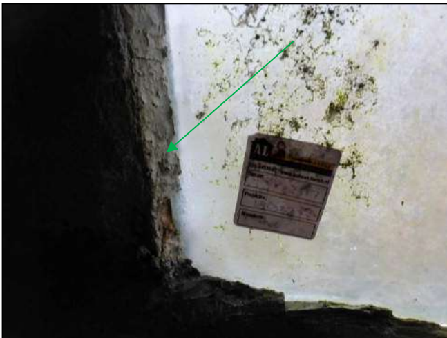
Foto 33: Schuur 2: Stopverf (M06V & M07V)
