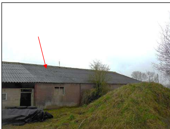
Foto 41: Schoor 2: Golfplaten dak (M08AA)
