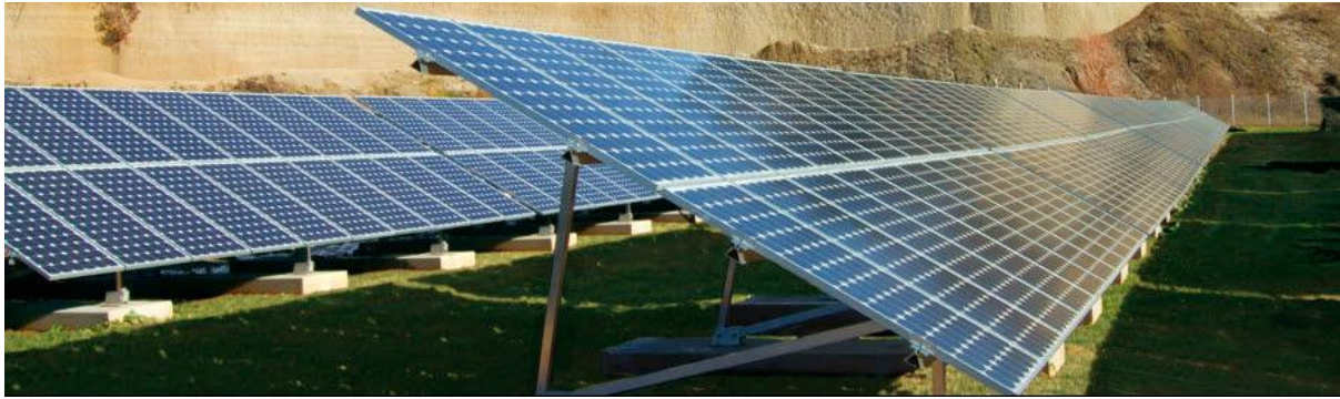
Afbeelding 16: Voorbeeld onderconstructie met betonvoeten
