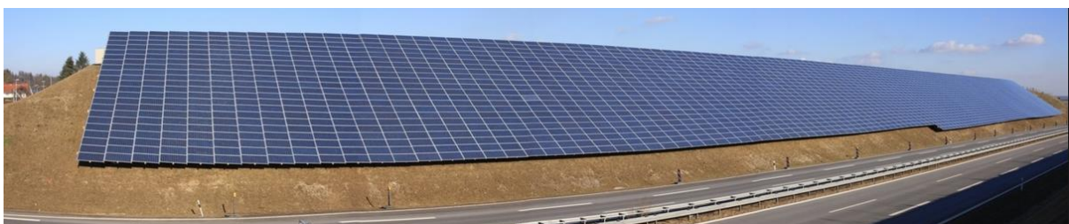
Afbeelding 19: Zonne installatie langs de a94 dicht bij Togg
