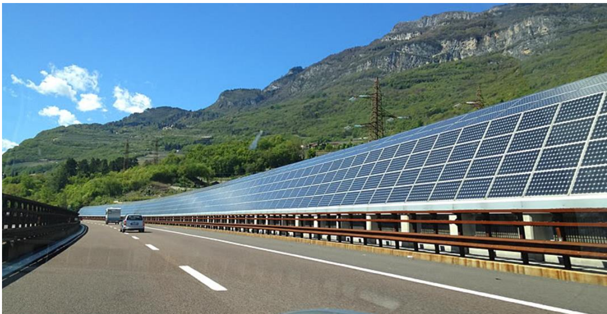
Afbeelding 18: Zonne installatie langs de “Brennerautobahn” in Italië
