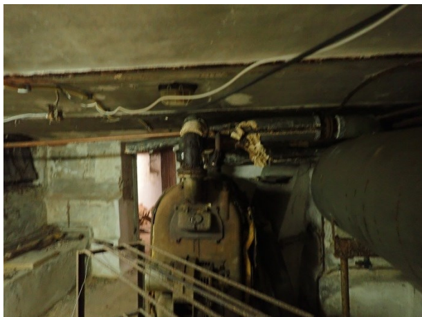
Foto 18: de kelder met de oude verwarmingsketel.
