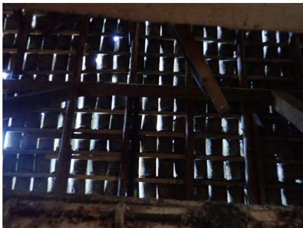
Foto 2: het kierende pannendak.
