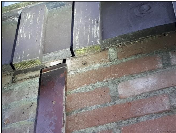
Figuur 24. Ruimte achter betimmering ontmoetingsgebouw.
