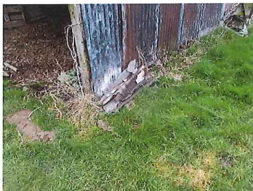
Foto 9: Stukken golfplaat op maaiveld (003)
