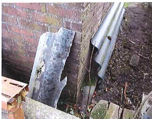
Foto 12: Stukken golfplaat op maaiveld (003)
