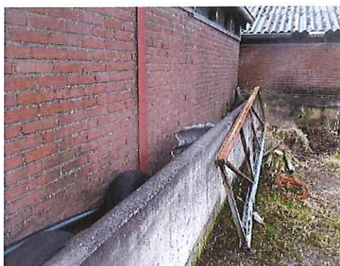
Foto 10: Stukken golfplaat op maaiveld (003)
