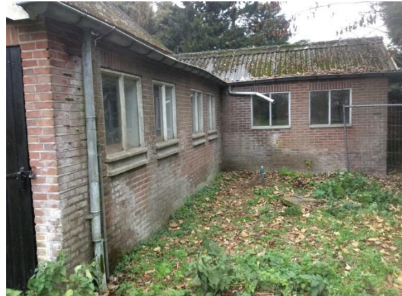
Figuur 9: Defecte dakgoot
