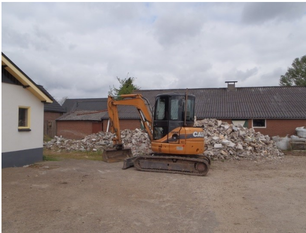
Foto 5: vervallen schuur en voormalige verstalling zijn op de achtergrond zichtbaar. De foto geeft ook een goed beeld van de erfverharding.
