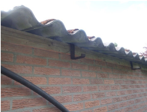
Foto 2: detail van de dakconstructie. Op de foto is duidelijk de balk zichtbaar die bovenop de spouwmuur is aangebracht en die de toegang tot de spouwmuur onmogelijk maakt. Onder de cementgebonden platen zijn de openingen zichtbaar die leiden tot de ruimte tussen deze platen de isolatieplaten.
