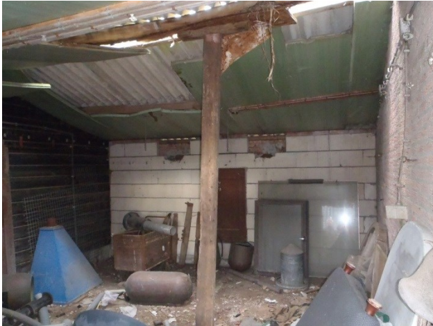
Foto1: vervallen schuur. Op de achtergrond is de plaats zichtbaar waar de muur beschadigd is en zich de twee oude merelnesten bevinden. Ook is de dakconstructie door de kapotte isolatieplaten goed zichtbaar.
