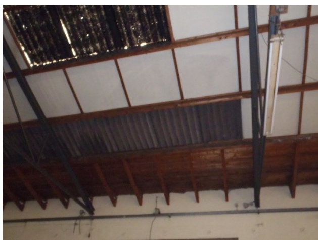
Foto 3: Velinghal 1 met het geïsoleerde golfplaten dak
