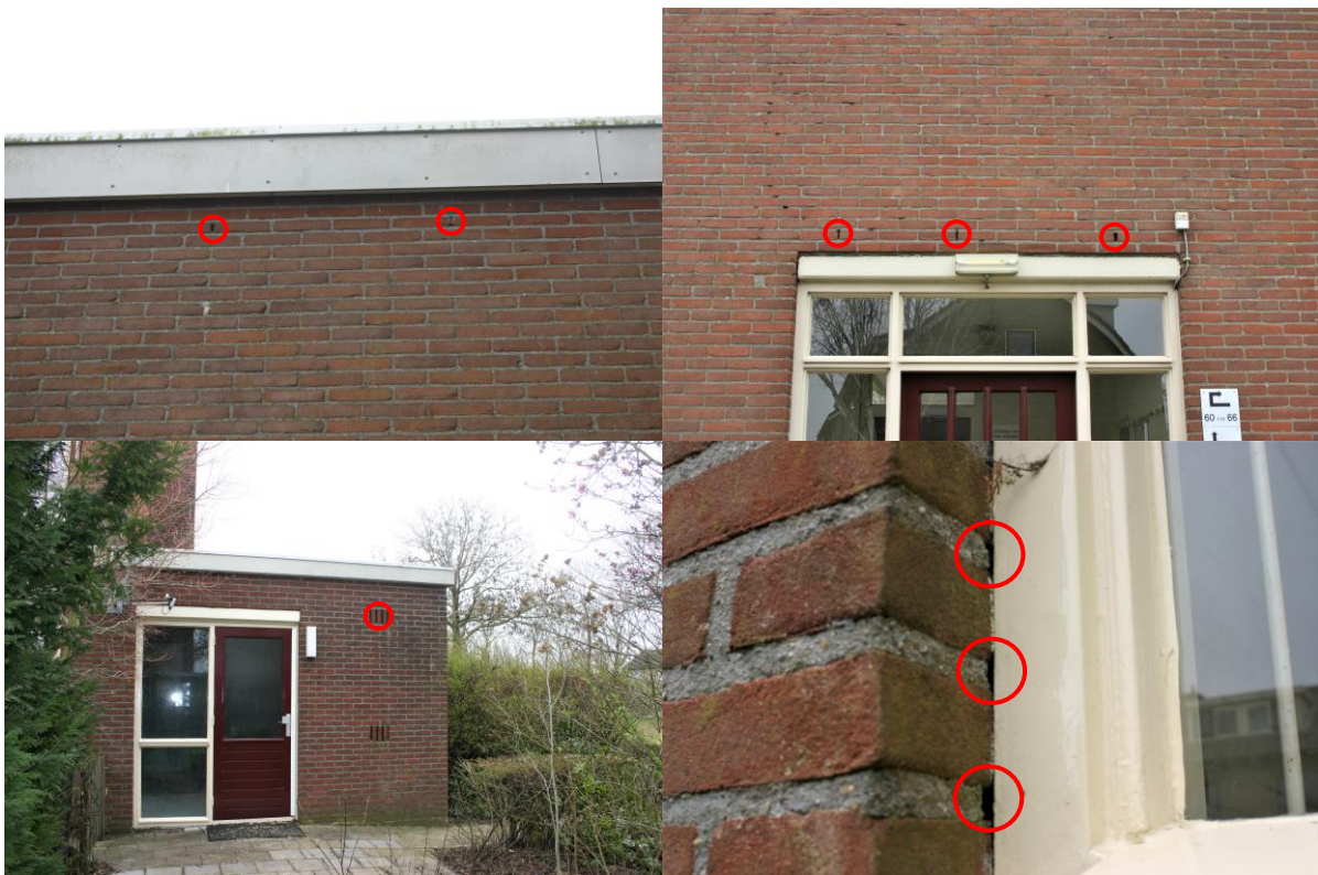
Figuur 4.4.1. In de bebouwing in het plangebied zijn diverse openingen (rode cirkels) aanwezig, zoals open stootvoegen, ventilatiesleuven en kieren tussen kozijn en gevel. Hierdoor kunnen vleermuizen de achterliggende ruimte bereiken.
