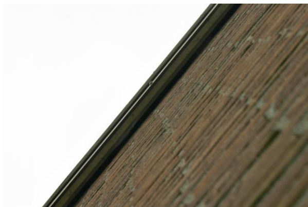
Figuur 4.4.2. Tussen de boeiboorden en de gevels zit een kier, waardoor vleermuizen naar binnen kunnen kruipen.
