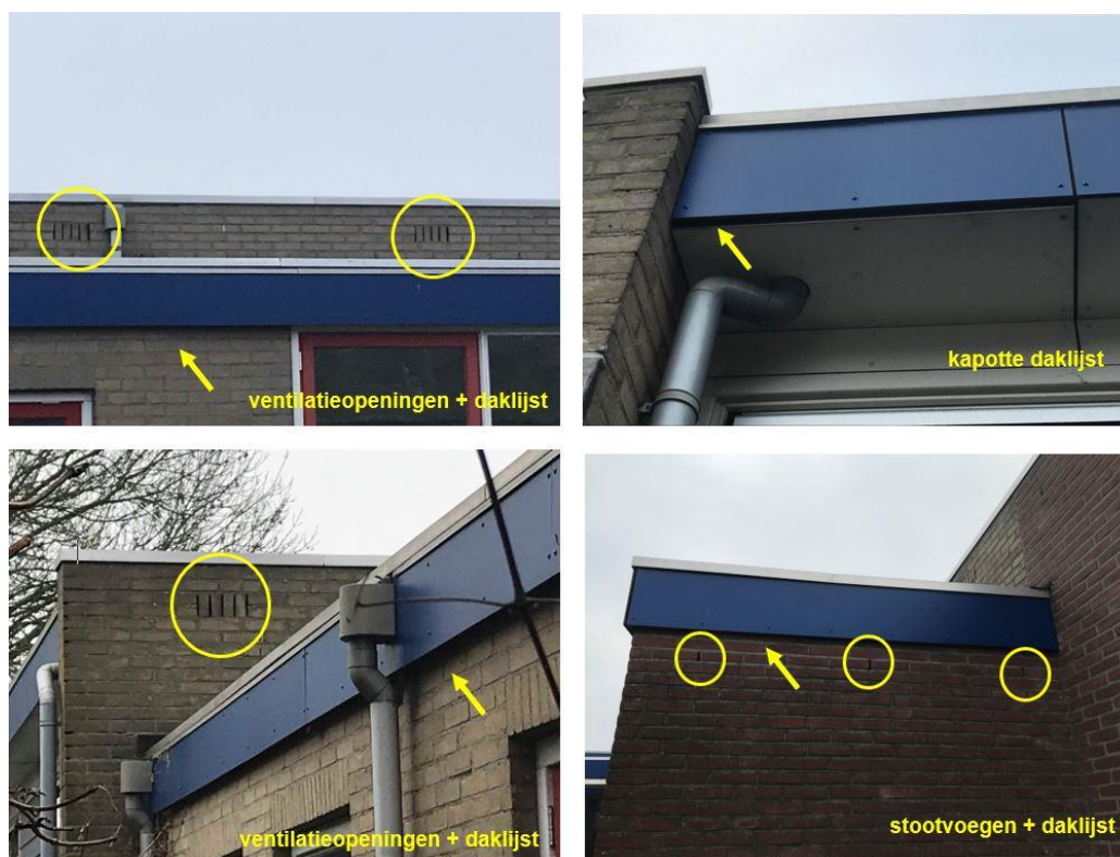
Figuur 6 Potentiele invliegopeningen voor vleermuizen in het schoolgebouw.
