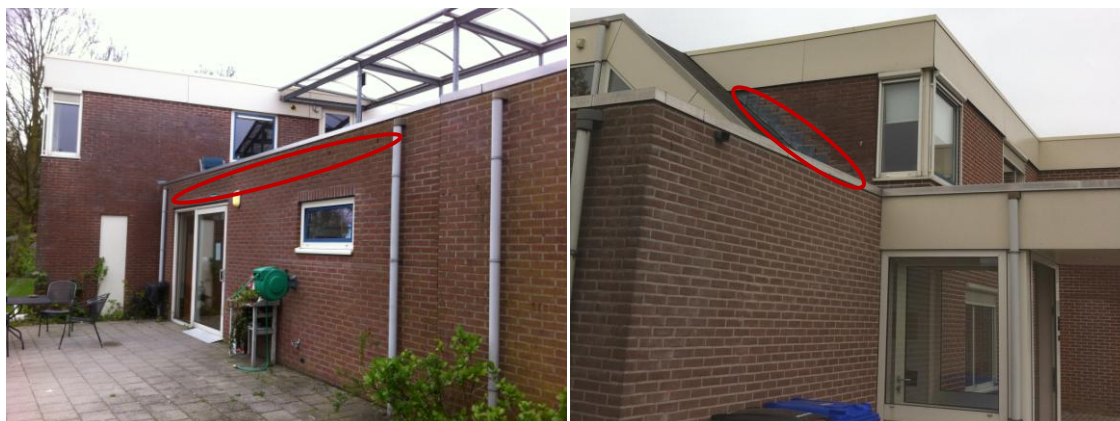
Figuur 2. Beide gebouwen hebben op diverse plekken open stootvoegen (rood omcirkeld) en andere potentiële invliegopeningen.
