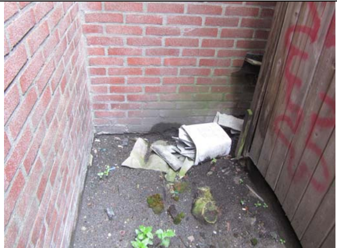
Asbest op maaiveld tussen kerkgebouw en houten schuur met asbesthoudende dakbedekking nabij G10 en ASB15
