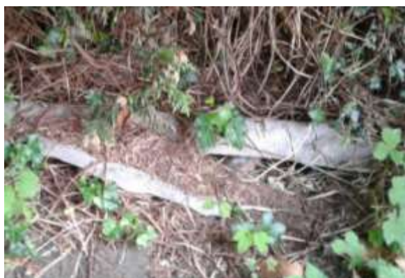
Foto 3: Asbestverdacht materiaal op maaiveld (M01)
